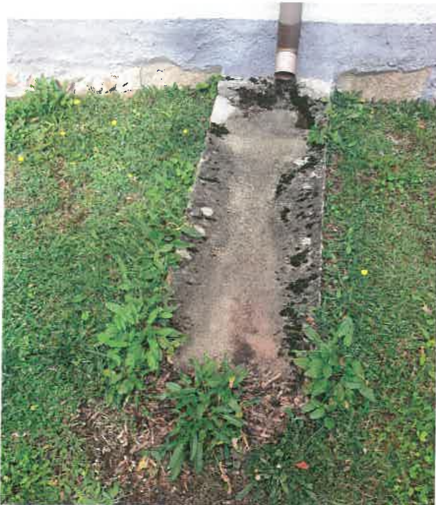
Zdjęcie nr 6: Odprowadzenia wód z rur spustowych na teren przyległy
