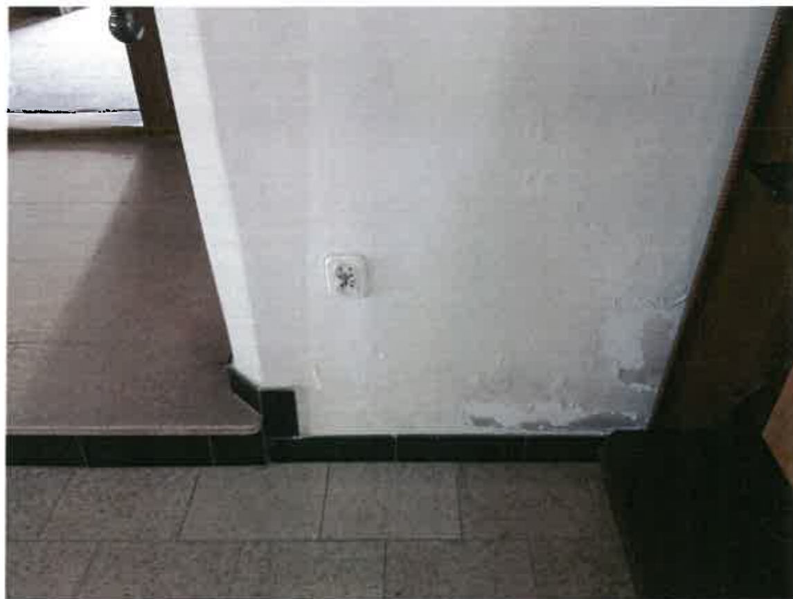
Zdjęcie nr 1: Łuszczenie farby emulsyjnej na ścianie wewnętrznej
