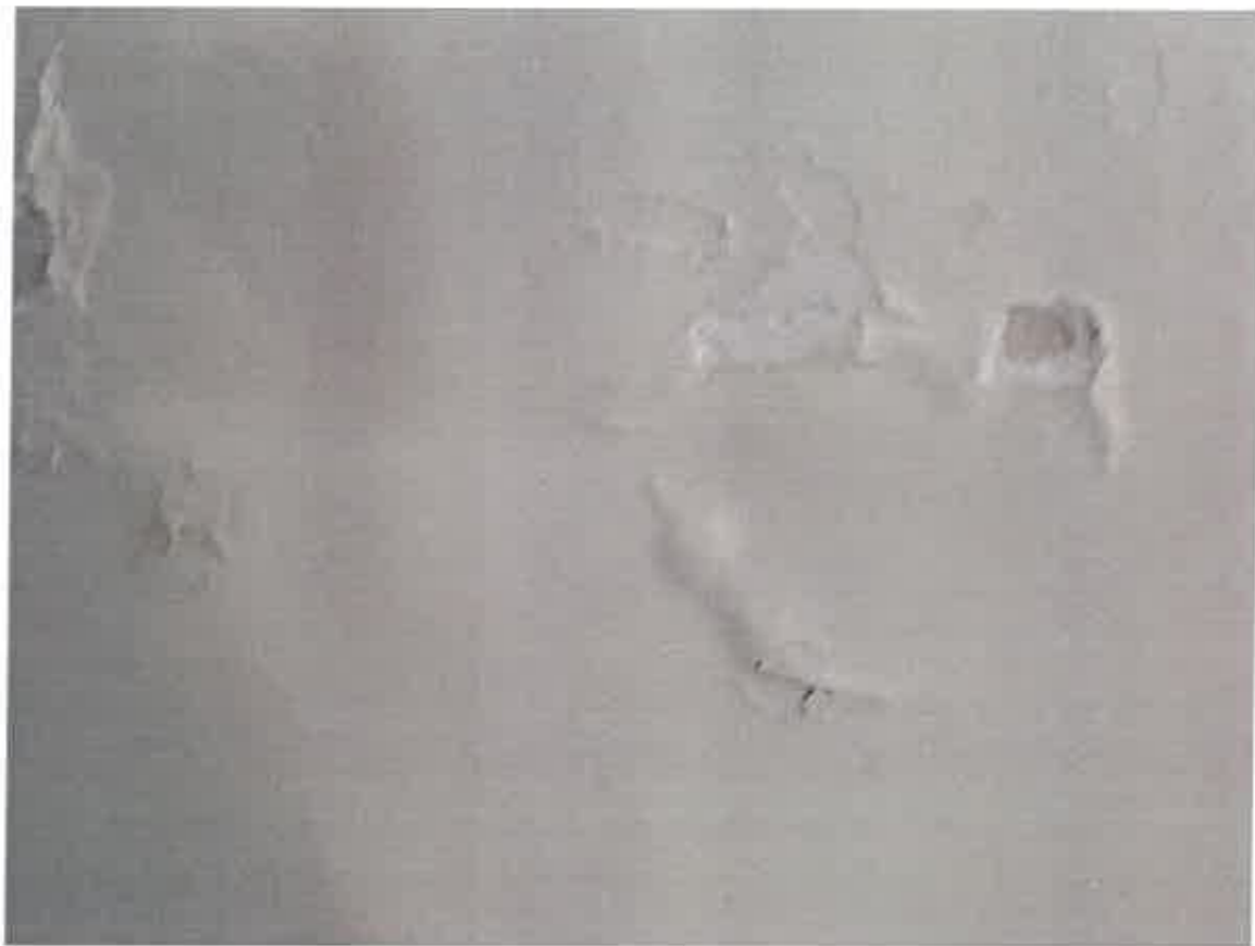
Zdjęcie nr 2: Odpadające pęcherze farby na ścianach wewnętrznych
