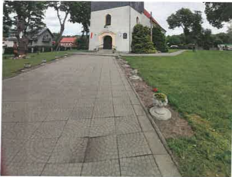
Zdjęcie nr 5: Utwardzenie od bramy do Kościoła – widoczne załamanie płytek
