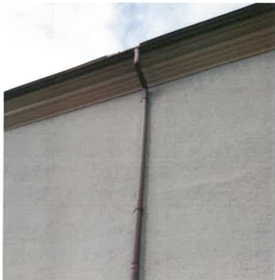
Zdjęcie nr 3: ubytki rynny w miejscu spływu wody do rury spustowej.
